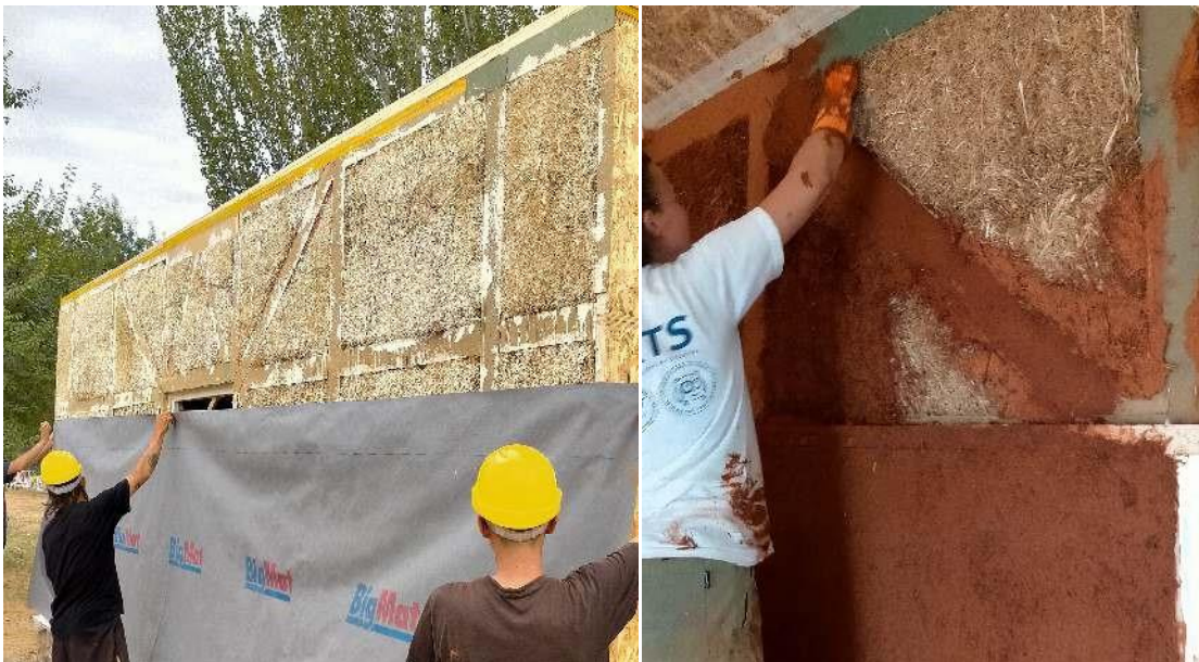
Imagen: acabados exteriores e interiores con distintas soluciones de morteros de cal y tierra.
